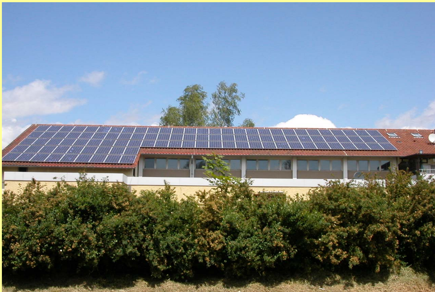
SonnenStrom-Bürgeranlage auf dem Dach der Turnhalle in Entringen
